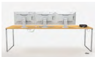
Daisy-Chain-Verfahren Aufgeräumtes Kabelmanagement
